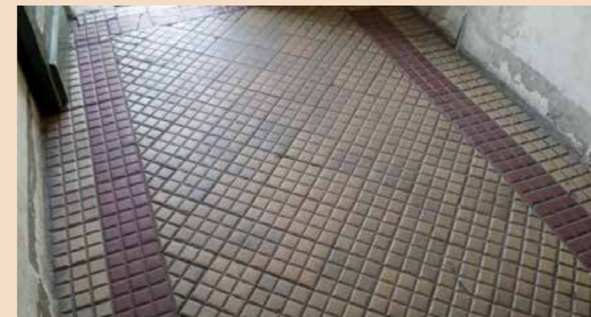
Obr. 31 Pokládka jemných dlaždic ve vídeňském domě (vzory IV, IVb-totožné s chodníkovou dlažbou) Bild 31 Verlegung feiner Platten in einem Haus in Wien (Muster IV, IVb - identisch mit den Gehsteigplatten)
